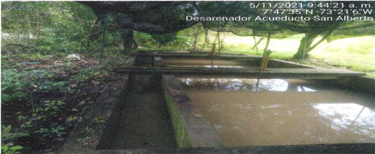
Figura 4. Desarenador EMPOSANAL S.A E.S.P.,
